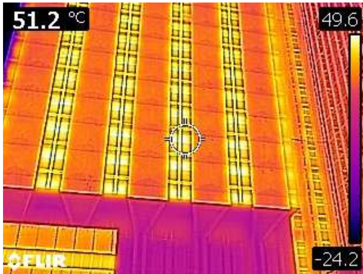
Thermographie de la façade sud, juillet 2021. La température des allèges en tôle marron atteint 50°C. Thermographie Marc Benard
